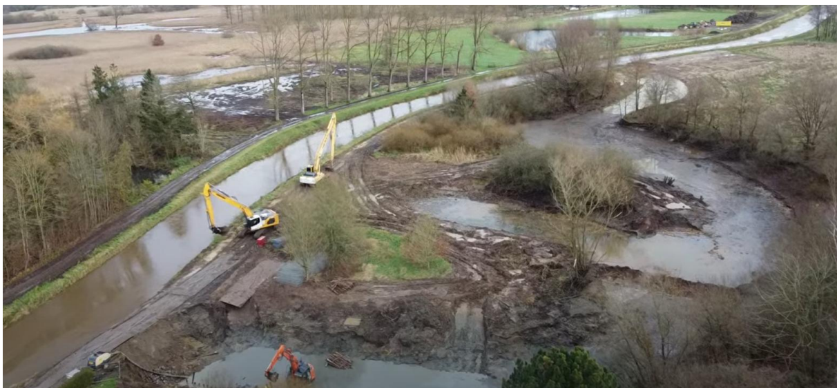
Figuur 9 Luchtfoto werken tijdens de voorbereiding van de aantakking van de meanders
